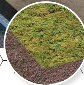
Gestion de l'eau pluviale avec plantes sédum
